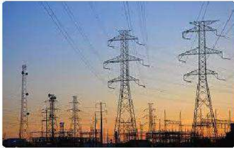
Đường dây điện cao thế.
