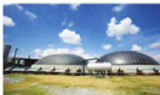
Hình 2.11. Thiết kế hầm biogas dạng phù bạt HDPE trong các trại chăn nuôi công nghiệp
