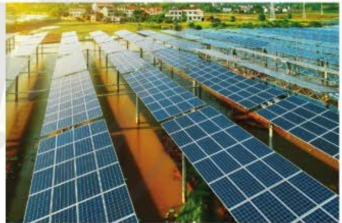
Hình 12.4. Nhà máy điện mặt trời
