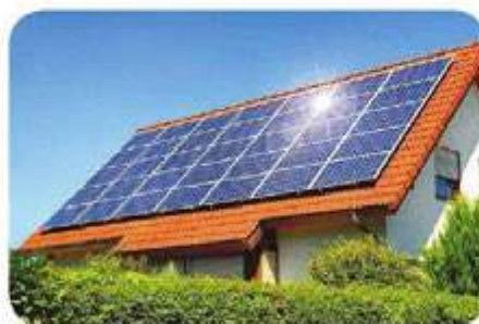
Hình 2. Hộ gia đình lắp đặt điện mặt trời áp mái (Nguồn: vista.gov.vn)
