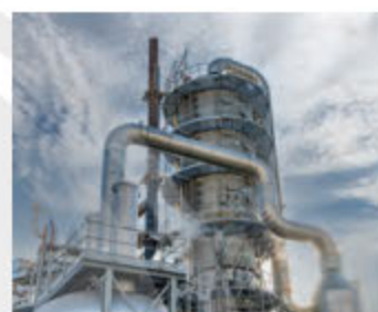
▲ Cột chưng cất phân đoạn hoá dầu
