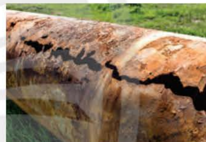
▲ Đường ống dẫn nước bị hư hỏng do sự ăn mòn kim loại
