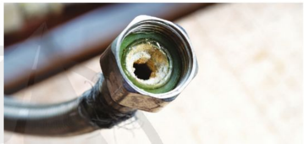
Hình 19.1. Một đoạn ống nước bị đóng cặn
