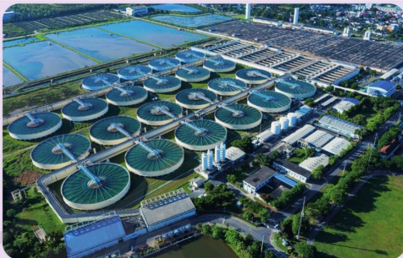
Các bể chứa nước trong nhà máy xử lý nước có diện tích bề mặt lớn để nước tiếp xúc nhiều với không khí
